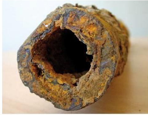
Vieillissement des canalisations
