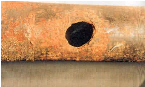
Photographie n°2. Conduite de diamètre 80 mm ayant subi une corrosion externe localisée
