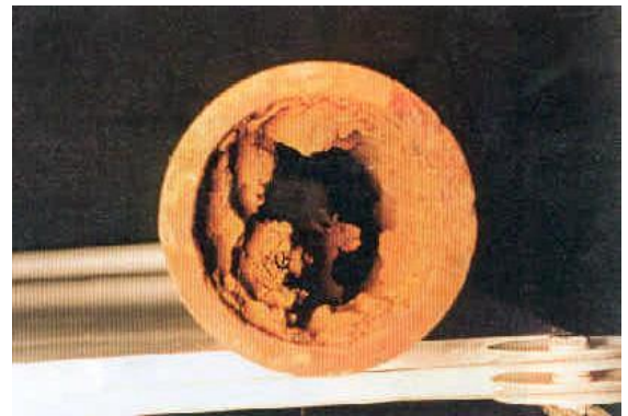
Photographie n°1. Conduite de diamètre 80 mm ayant subi des dépôts ferriques de corrosion interne
