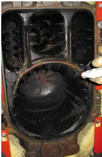
Facultatif : pré-nettoyage chimique du corps de chauffe.
