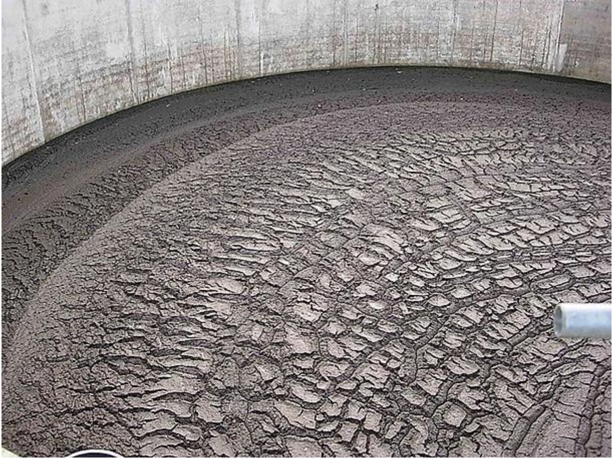
Figure III.5 : La décantation primaire
