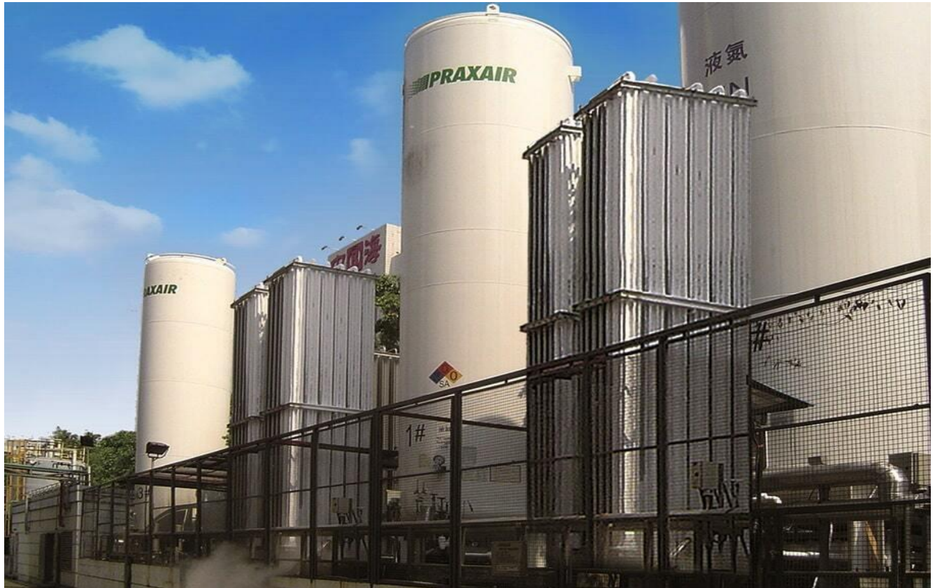
Figure 3. Stockage cryogénique et vaporisateurs
