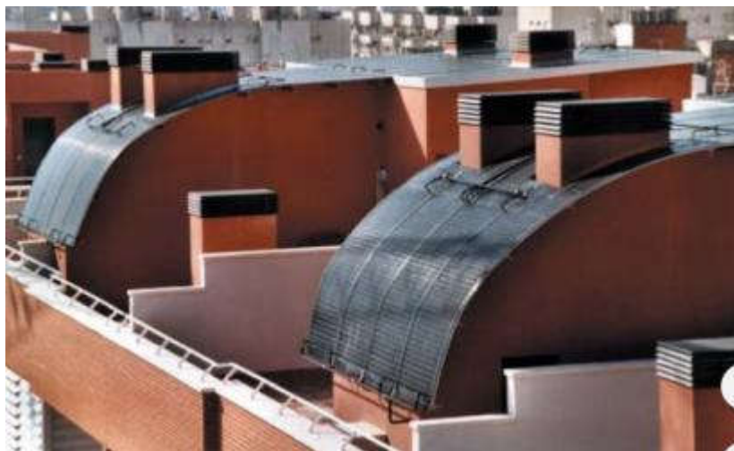
Figure : Installation de production d'eau chaude sanitaire.
