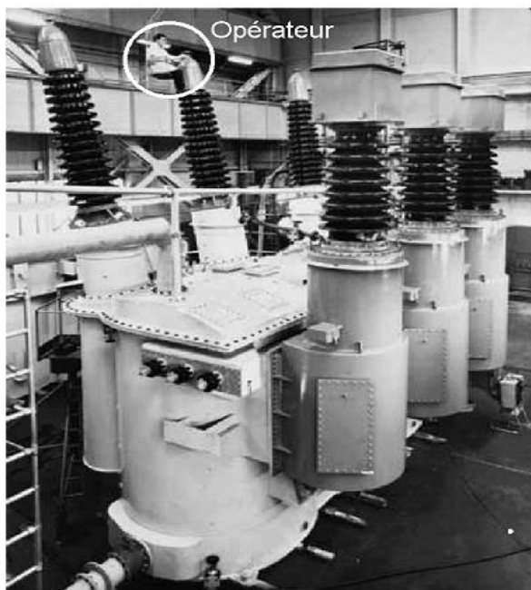
Transformateur 400kV / 130kV
