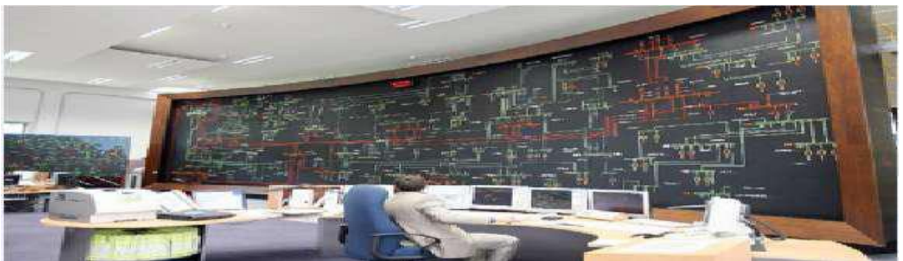
Figure III.7: Vue générale d'une salle de dispatching
