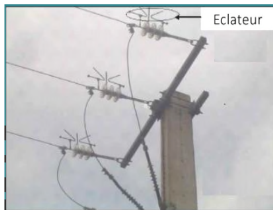
Figure 14 : Photo d'un éclateur à air.
